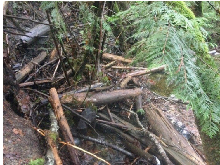
2.) Wolf Creek culvert log Jam
